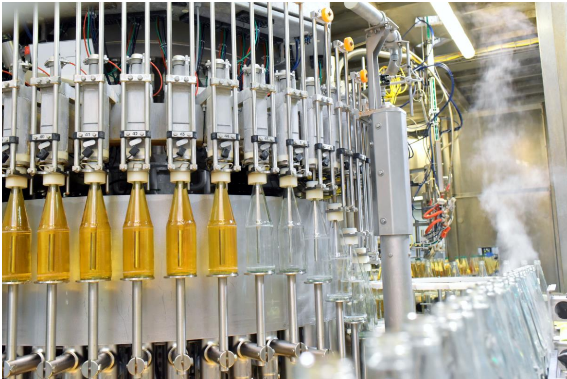
Abfüllanlage in einer Süßmosterei – Abfüllung und Förderband
