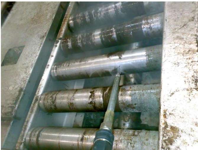
Reinigung Förderband mit Niederdruck-Heißreinigungsverfahren: Schonend, umweltfreundlich, und hoch effizient. Deutlich erkennbar die bereits gereinigten Zonen an der mittleren Rolle.
