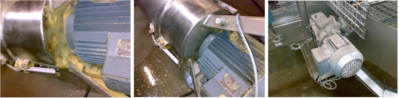
Elektromotoren: Links Zylinder ungereinigt, Mitte Zylinder gereinigt; rechts mit Mehlstaub verklebt
