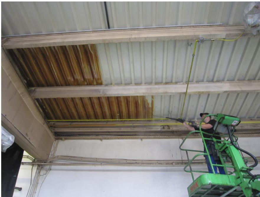
Niederdruck-Heißreinigung einer mit Ölnebel verschmutzten Hallendecke aus der Arbeitsbühne eines Hubsteigers heraus:
